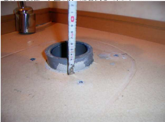
①洋風便器 手直し前 配管高さ 床より30mm
